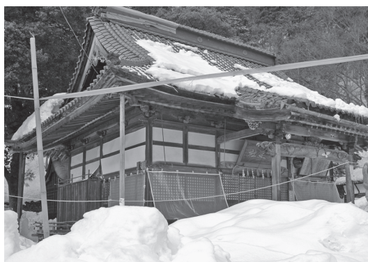
倒壊の恐れから境内全体が立ち入り禁止となっている柳廼社の拜殿
