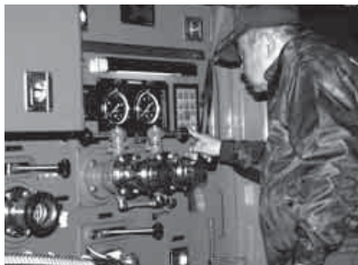
▲消防ポンプ車を念入りにチェック
