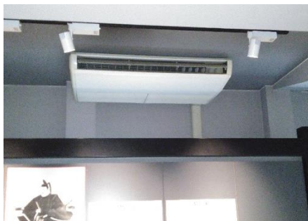
<天守閣内の空調設備（家庭用エアコン）>
