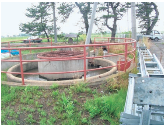
図88 松野木川と旧阿部堰の合流点にある揚水機場（水野尾ポンプ2号）
