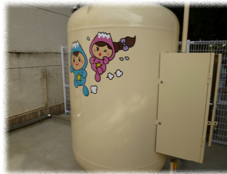
ガスバルブタンク
