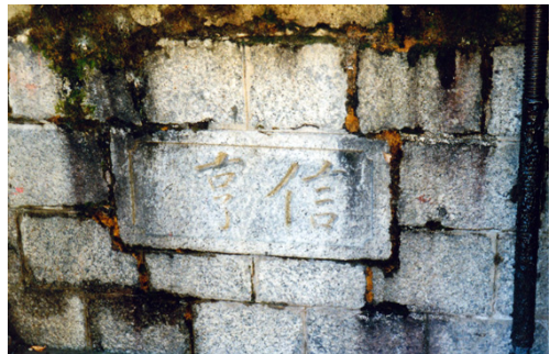
上村発電所 取水口「信亨」(井上角五郎)
