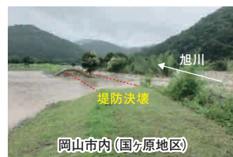
平成30年7月豪雨 (被災箇所は岡山県管理区間)
