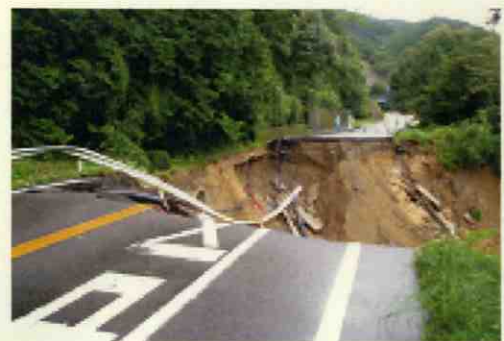
豪雨による現道の災害状況
