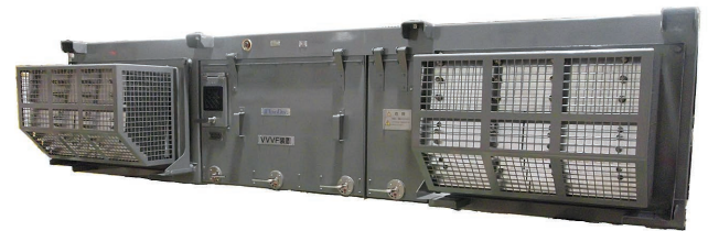
■ 図3 VVVFインバータ装置外観 Fig.3 VVVF inverter
