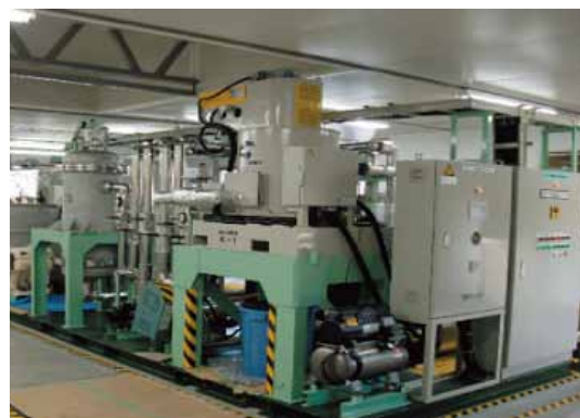
ワックス剥離廃液処理装置
