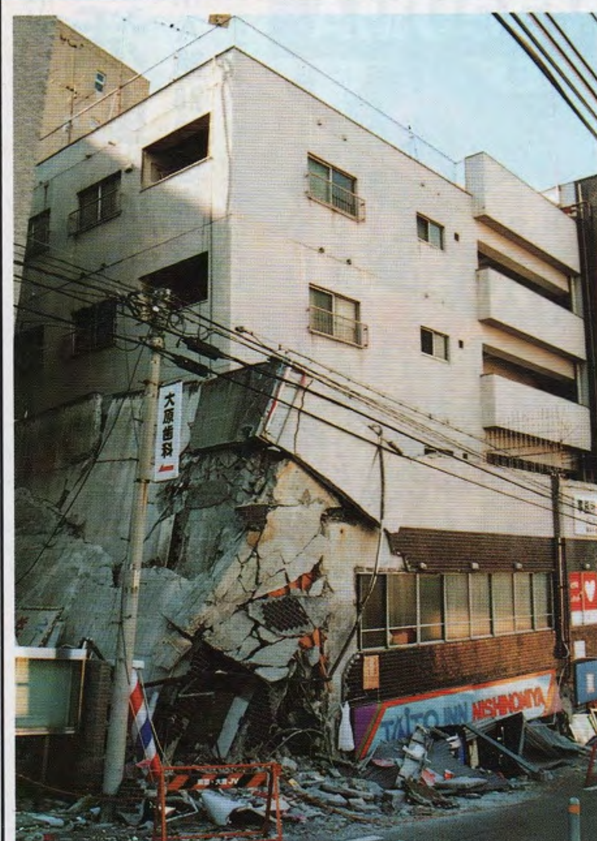
上の写真は西宮市のテツカ所有5階建てビルだが、1階にあったはずのタイトーのロケは地下にもぐり込んでしまい、地面のわずかなすき間から店内の倒壊したゲーム機などが見える(下)。2階事務所、3-5階は住宅だった
