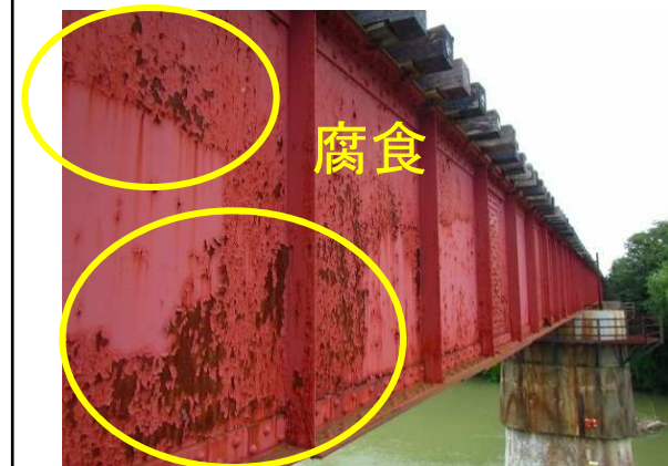
腐食が発生した橋りょう
