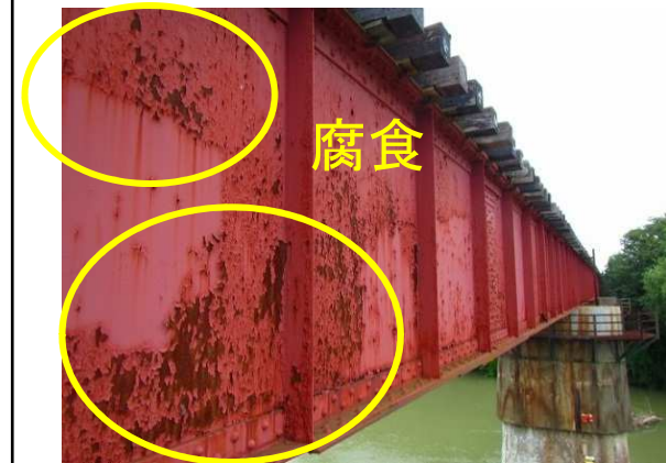
腐食が発生した橋りょう
