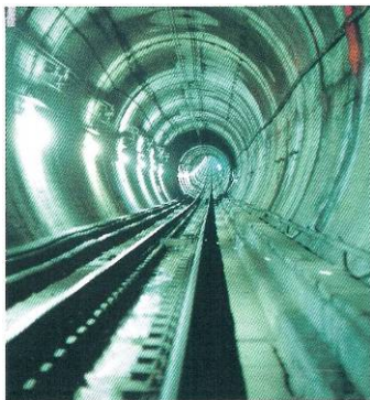
【関門鉄道トンネル】 （山口県下関市、福岡県北九州市門司区）
