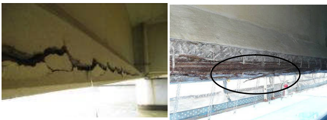
写真-2 G4桁クラック(左)とPCケーブル破断(右)
