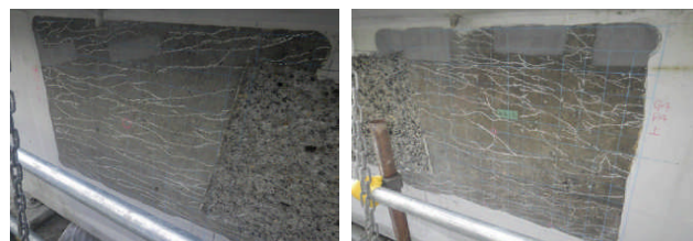
写真-3 桁端部ウェブ部のクラック
