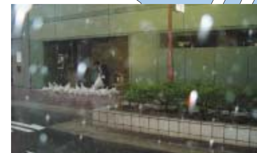
軒先に土を積みビル
