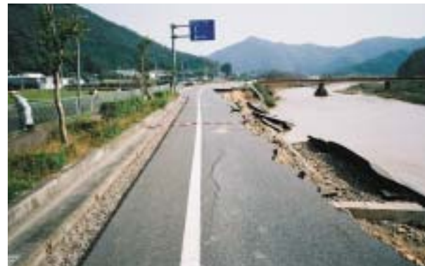
道路が流失した出石町の国道426号
