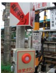
踏切支障報知装置
