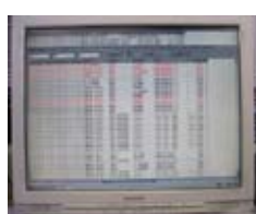
踏切集中監視装置
