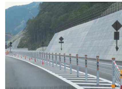
ガードケーブル型の簡易防護柵 対面通行区間の車線を分離し、車両の逸脱を防ぎます。
