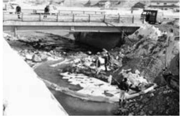
下流河川に張られたオイルフェンス
