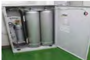
▲パッケージ型消火器設備
