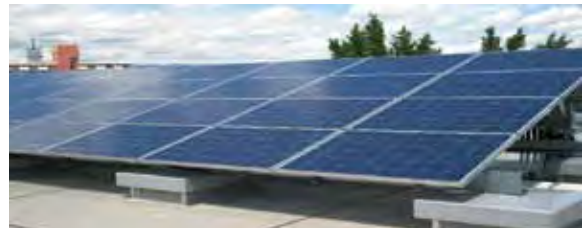
▲20KW 太陽光発電モジュール 某高校
