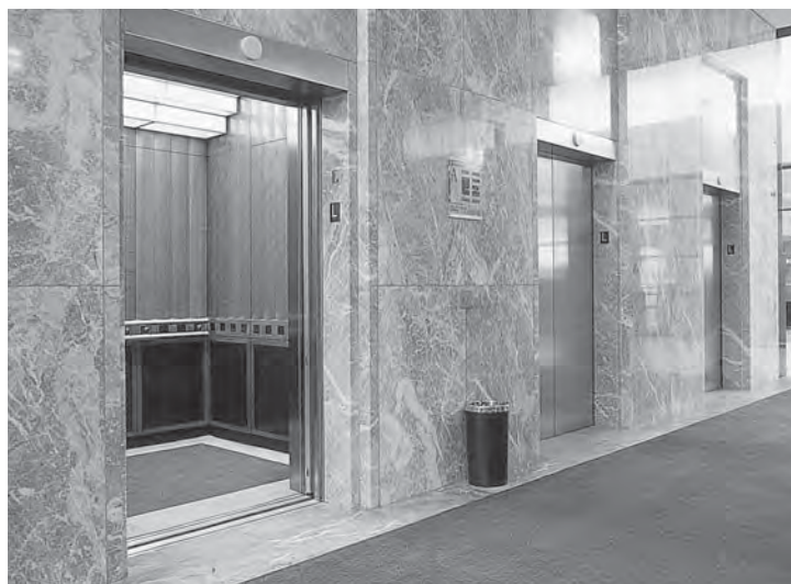
ニューヨークの「ワールド・ファイナンシャル・センター」に設置されたエレベータ（1986年12月）
