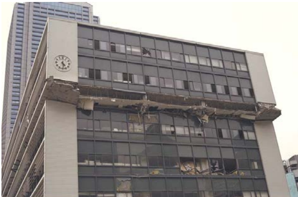
③1995 年 4 月 30 日の神戸市役所 2 号館
