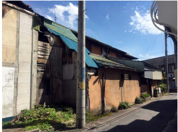
崩壊するトキワ館側面 (2018.6)
