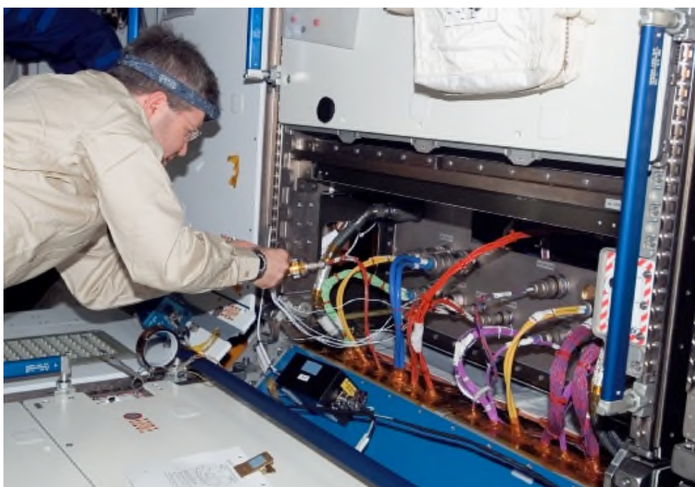
図3.4-12 ハーモニーの電力・通信配線のトラブルシュート (故障箇所の究明)
