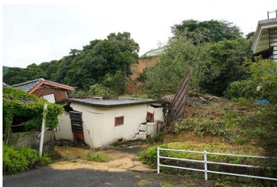
崩土により変形した家屋
