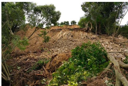
崩壊面は風化した頁岩，砂岩
