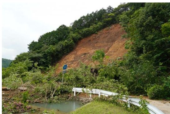
崩壊物が道路を塞ぐ
