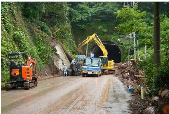
佐敷トンネル入り口を塞ぐ土石流堆積物
