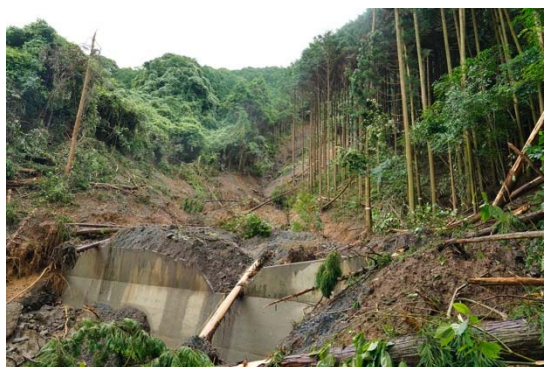
崩土は土石流となり堰堤を埋める
