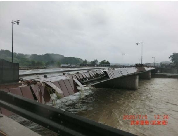
大橋の被災 板状の化粧板は、被災している
