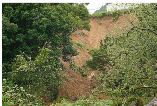
崩壊面の状況
