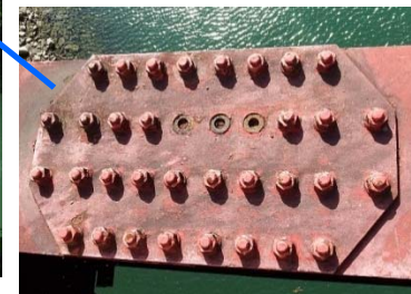
▲補剛桁の高力ボルト破断・抜け落ち状況
