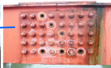
▲アーチリブの高力ボルト破断・抜け落ち状況
