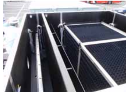
油分分離装置内部
