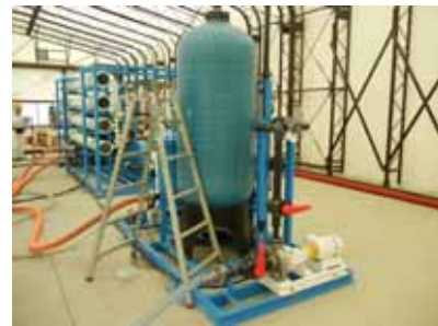
淡水化装置(ろ過装置)
