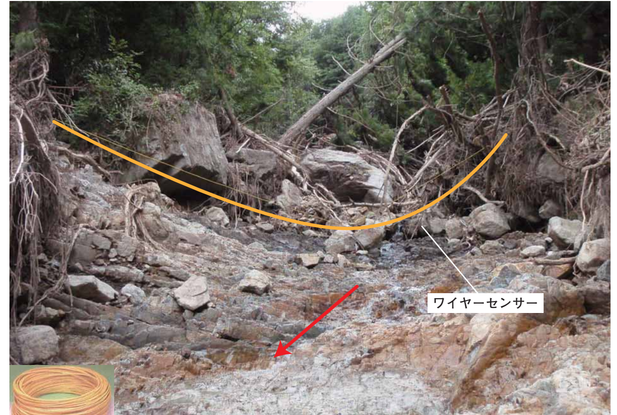
ワイヤーセンサー施工写真（大津恵川）
