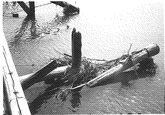
写真-16 破損した流木よけ (八幡橋 荒川水系越辺川 埼玉県)
