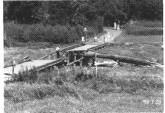
写真-6 上部工が被災した事例 (根本橋 久慈川水系里川 茨城県)
