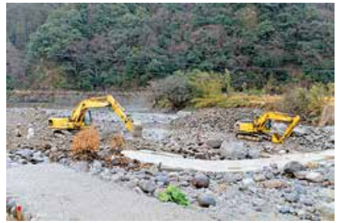
河川には流木や土砂が堆積している
