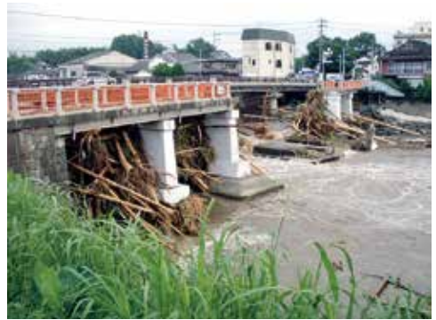
一部崩落した合志川（泗水地区）合志川橋
