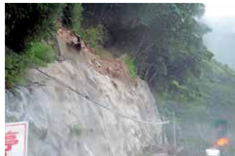
豪雨によって斜面の崩壊も見られた
