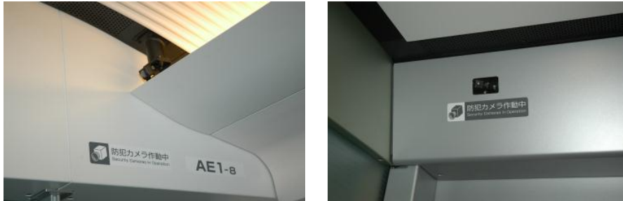
▲A E形に設置している防犯カメラ
