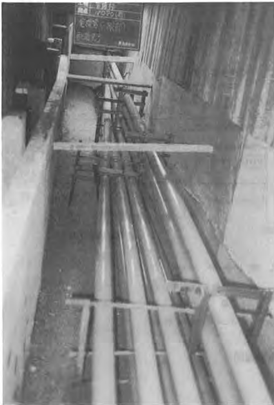
写真一 一般部配管
