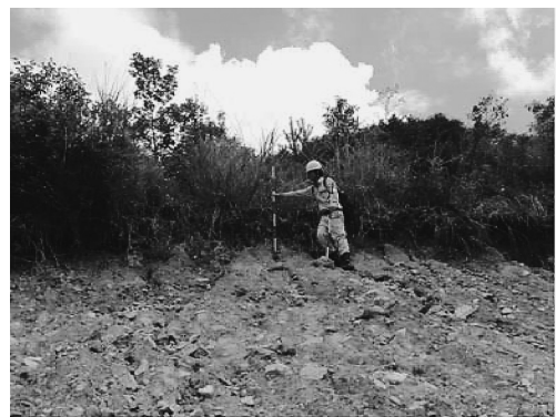
写真13 崩壊斜面の頭部
