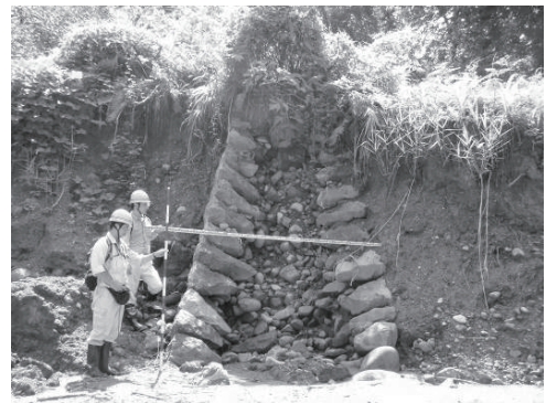
図5 7号堰堤（空石積）袖部被災状況
