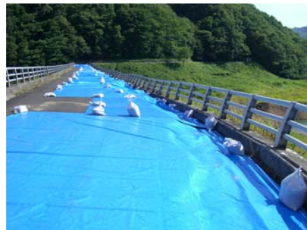
写真-26 天端の変形
