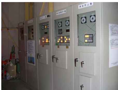
写真-6 ゲート操作盤
