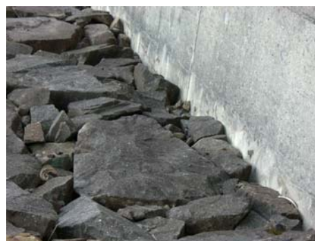
写真-4 洪水吐きとフィル部の沈下差異
