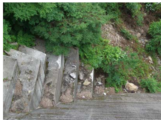
写真-13 フーチングの損傷
