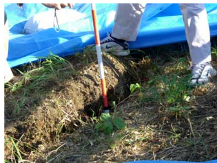
写真-28 下流面クラック
