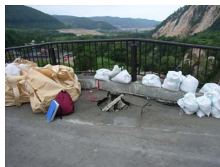
写真-17 天端・転落防止柵の変形 （後日入手したもの）
