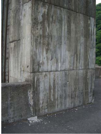
写真-10 門柱と天端転落防止壁間の損傷
