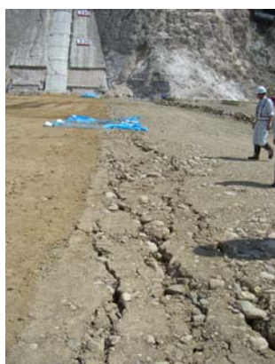
写真-20 盛り立て面でのクラック
