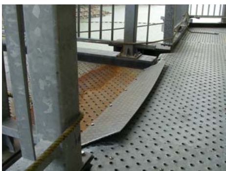
写真-5 取水塔取付橋梁の損傷
