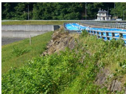
写真-27 天端・堤体の傾倒
