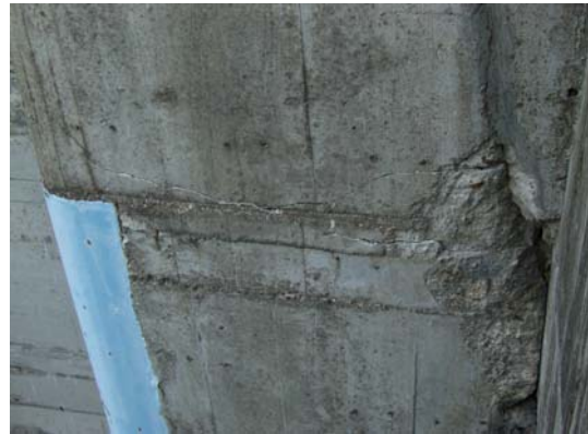
写真-11 門柱のクラック
