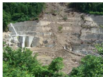
写真-24 転流工付近の法面崩壊
