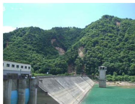
写真-19 右岸アバットの土砂崩壊
