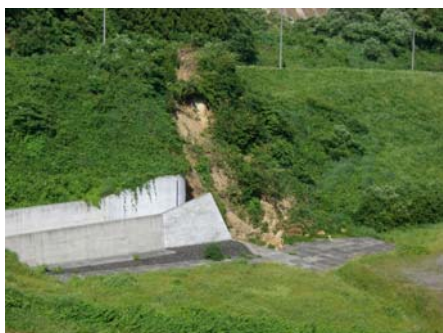
写真-29 洪水吐き下流の法面崩壊
