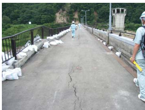
写真-16 天端のクラックの状況 （後日入手したもの）
