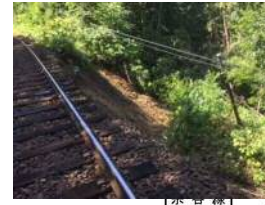
【盛土崩壊】 石北線 上川～白滝 76k690m付近
