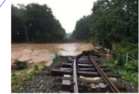
【橋りょう流失】 根室線 新得～十勝清水 第1佐幌川橋りょう
