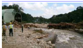
【線路流失】 根室線 落合～新得 広内(信) 第2谷間川橋りょう
