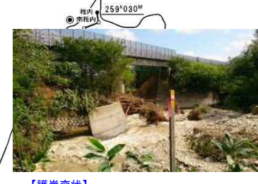
【護岸変状】 根室線 落合～新得 第1谷間川橋りょう
