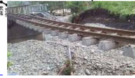
【路盤流出】 根室線 御影～芽室 芽室川橋りょう
