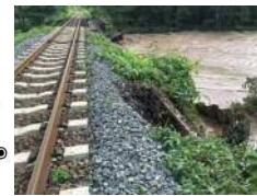
【路盤流出】 根室線 十勝清水～羽帯 平野川橋りょう
