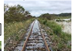
【線路冠水】 釧路線 塘路～茅沼 27k950m付近
