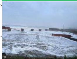
【橋りょう流失・路盤流出・通信ケーブル損傷】 日高線 豊郷～清島 慶能舞川橋りょう
