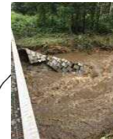
【護岸変状】 根室線 十勝清水～羽帯 155k304m付近 魚捕川橋りょう
