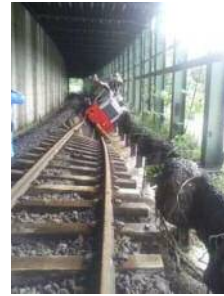
【路盤流出】 石北線 上川～白滝 53k100m付近
