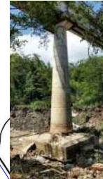
【橋脚洗掘】 根室線 落合～新得 123k912m付近 第2ベンセントクナイ川橋りょう
