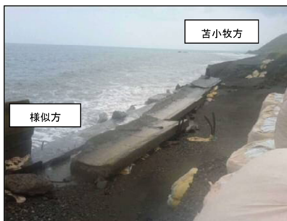
被災状況写真 (9/14 プレス発表)
