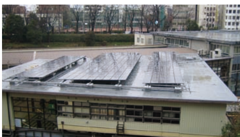
四ツ谷駅の赤坂口本屋に設置された太陽光発電パネル
