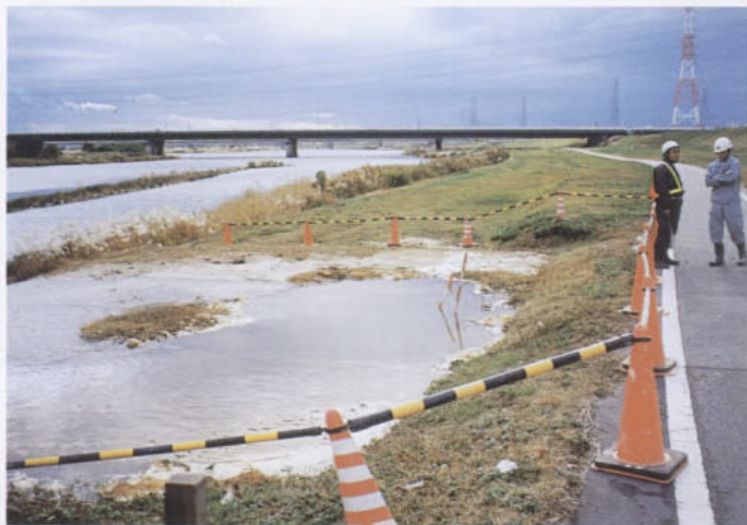
写真 1.2 高水敷に設置された工業用水道管の破損による噴出状況
