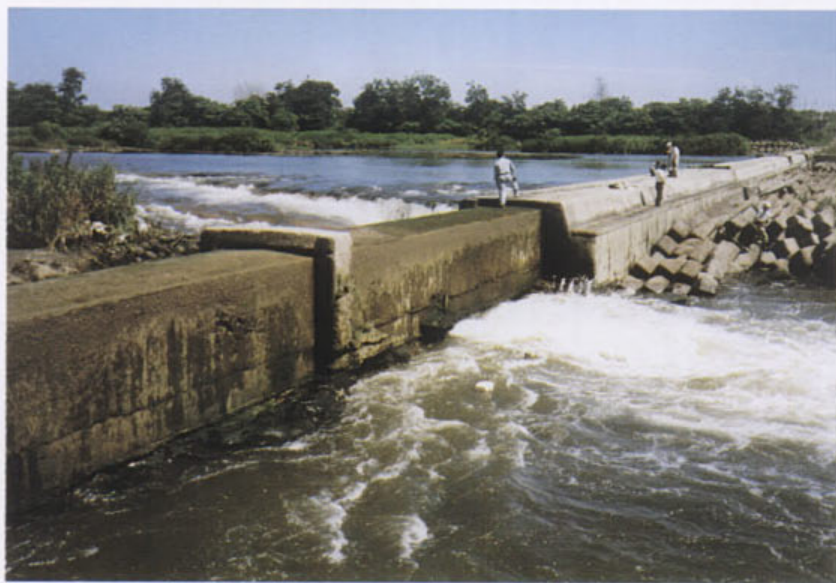
写真7.1 伏せ越しの露出事例
