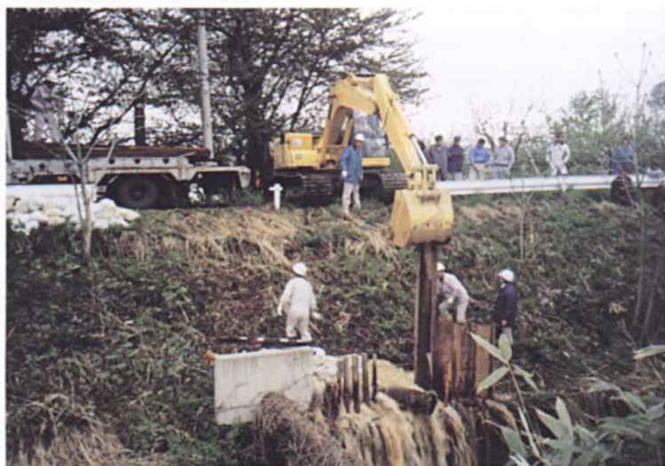
写真 1.1 樋門の漏水状況
