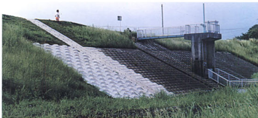
写真8.1 表法肩から堤外地側の部分を堤防法面に合わせて堤体内に埋設した事例
