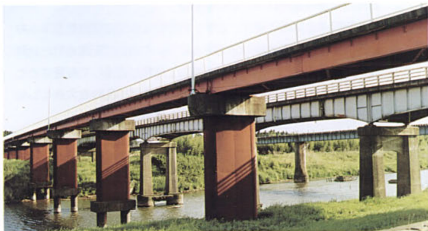
写真10.2 近接橋でかつ河床が低下して橋脚基礎が露出し対策が必要な事例
