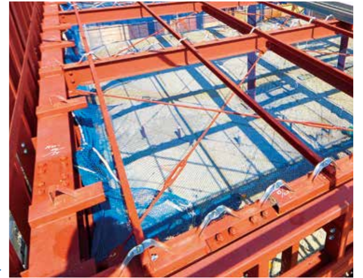
落下防止ネット ▶
