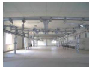
剛体電車線実習設備
