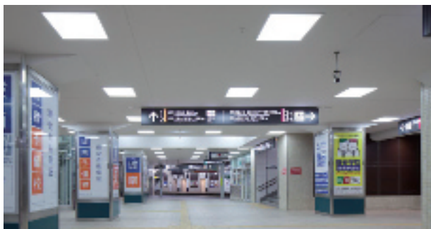
写真-2 コンコース照明
