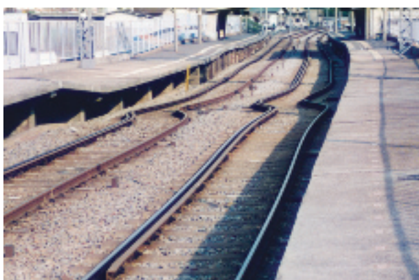
図7 被災した山陽塩屋駅
