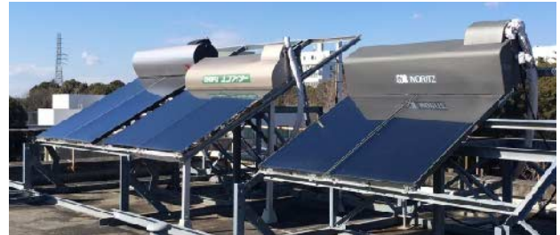
図 6 架台設置された太陽熱温水器三種
