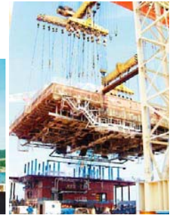
掘削作業の中心となるドリルフロアを搭載
