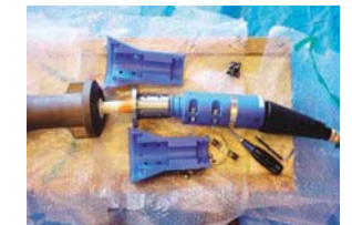
二次ケーブル引留部のカバー（ベルマウス）は取り外して内部が目視できるように改良され、潮航ごとに点検が行われる
