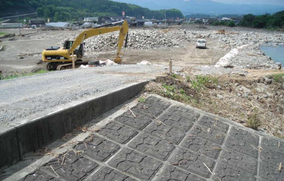
①地蔵元橋下流左岸が破堤し、氾濫水が堤内に流入した。右岸の集落では氾濫水の流入はほとんどない。
