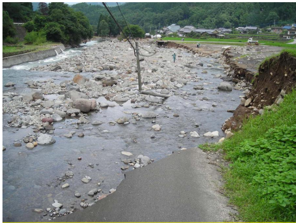
②花月川は右岸の攻撃斜面(堤防無)を大きく侵食し、河床では大礫による砂礫堆積が生じた。水田上に砂主体の砂礫が堆積したが、水田よりも低い左岸の高水敷に顕著な堆積物は見えない。
