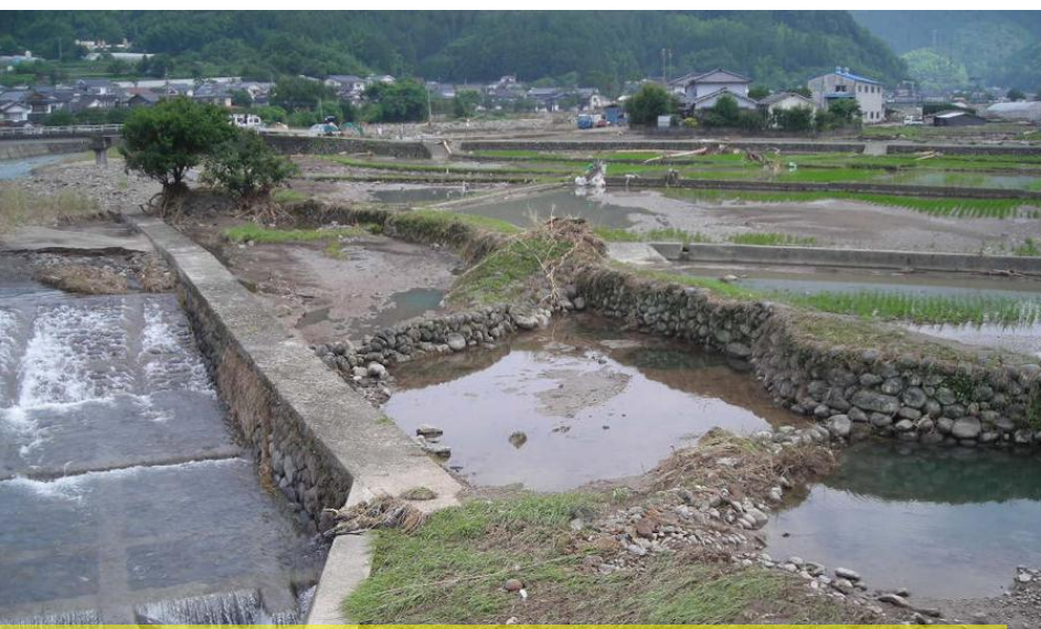
③破堤から下流500m付近では水田や住宅地に大量の砂が堆積した。また河川に戻る水による凹地が至る場所に形成された。
