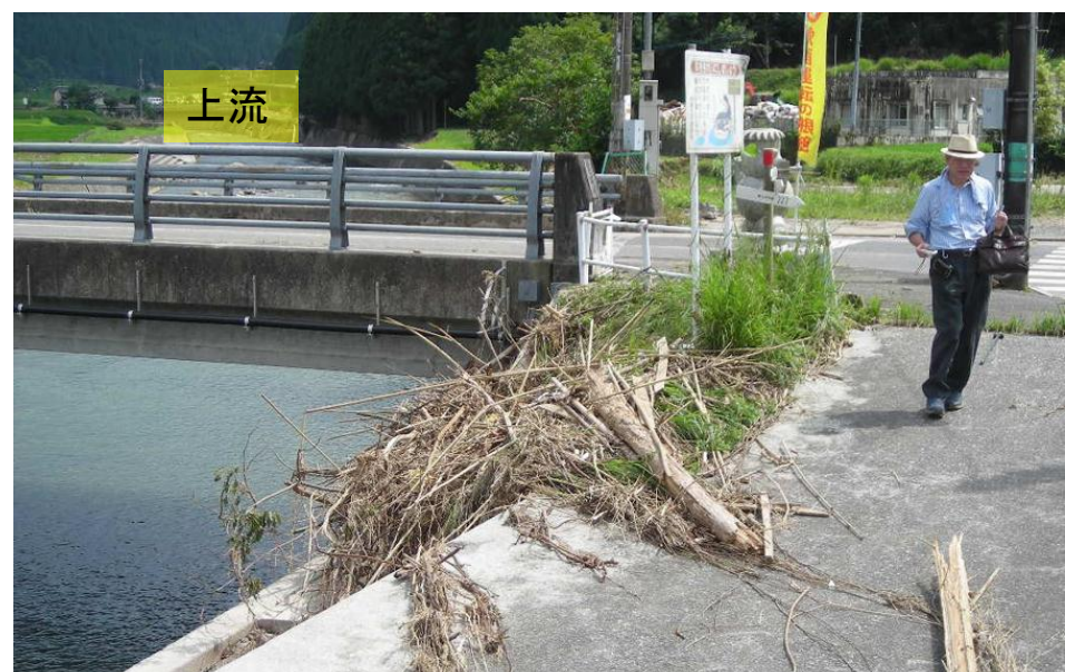
④山国川支流の金吉川では橋の下流側に多くのトラッシュが残されており、本流から洪水が逆流したことを示す。
