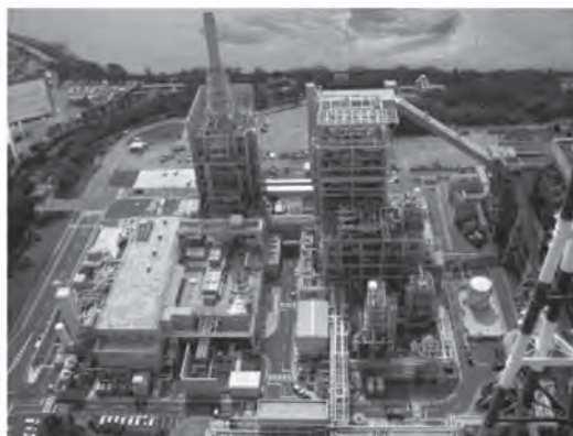
図 4.20 IGCC 実証機の全景
