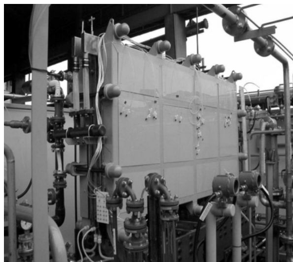
図8.5 ガス拡散電極法実用規模電解槽
