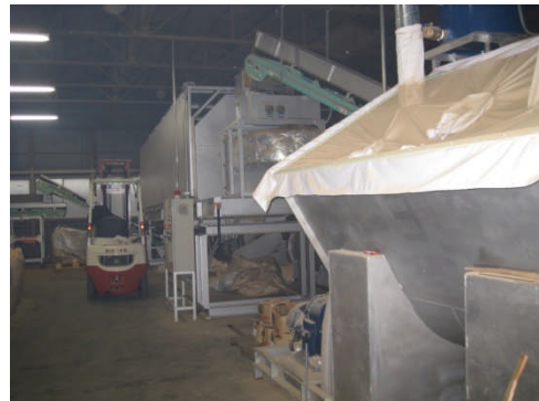
【工場内の乾燥機】
