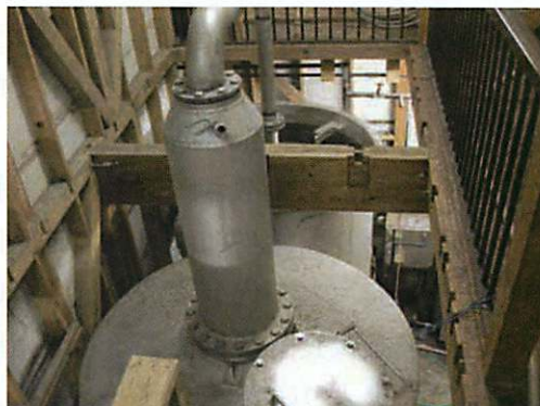
工場内の様子（蒸留装置）
