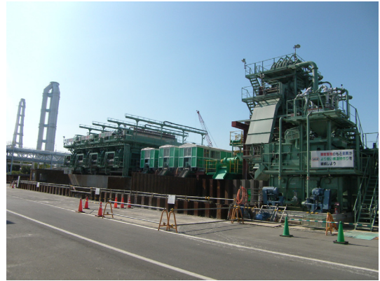
写真-5 泥水処理設備全景（川越側）
