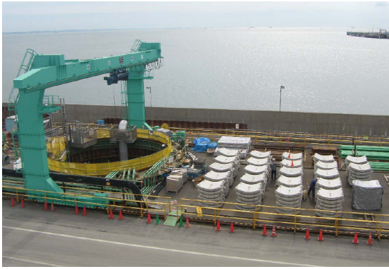
写真-2 高速橋形クレーン（定格荷重 7.5 t）
